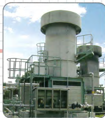
余剰ガス燃焼装置
