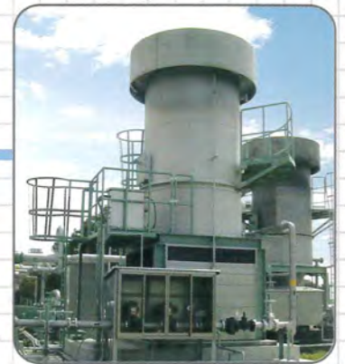
余剰ガス燃焼装置
