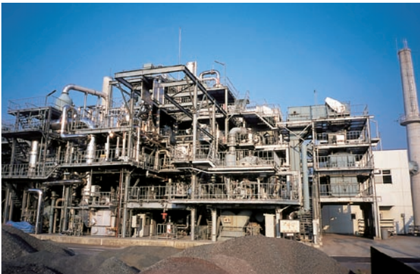
T下水処理場 京都市
